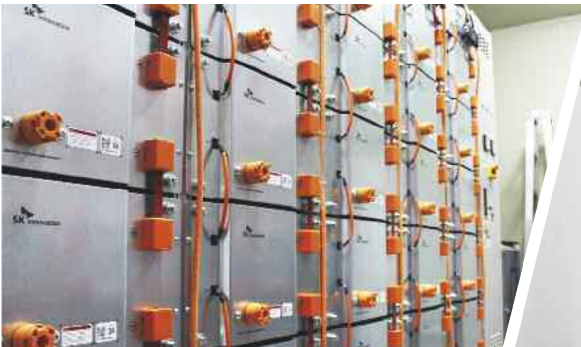
서울 성동구 티팩토리 본사 지하에 위치한 1.2MWh 용량의 피크 저감용 ESS.
